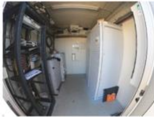
Zone technique du site BTS de Mercières (69)
